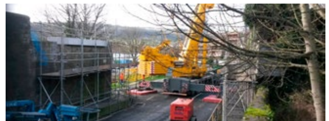
Oibreacha Tógála ar N24 Bóthar an Phoill Droichead Iarnróid Charraig na Siúire Feabhra 2017
